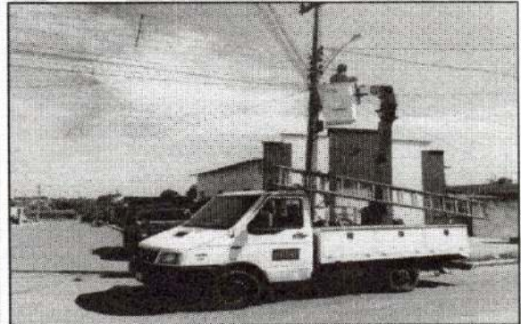
Figura 35: Manutenção da iluminação pública.
